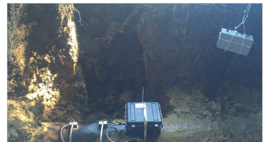
Auf großer Wasserleitung installierter Ultraschall-durchflussmesser KATflow 210.
