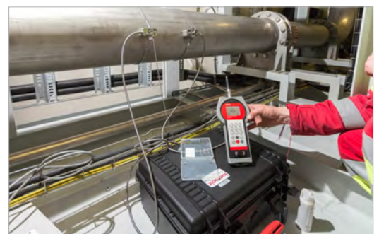
Der KATflow 200-Durchflussmesser im Raum für die Konverterkühlung auf der Offshore-Konverterplattform HelWin alpha.
