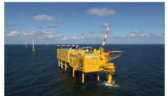
Offshore-Plattformen von TenneT TSO in der Nordsee.
